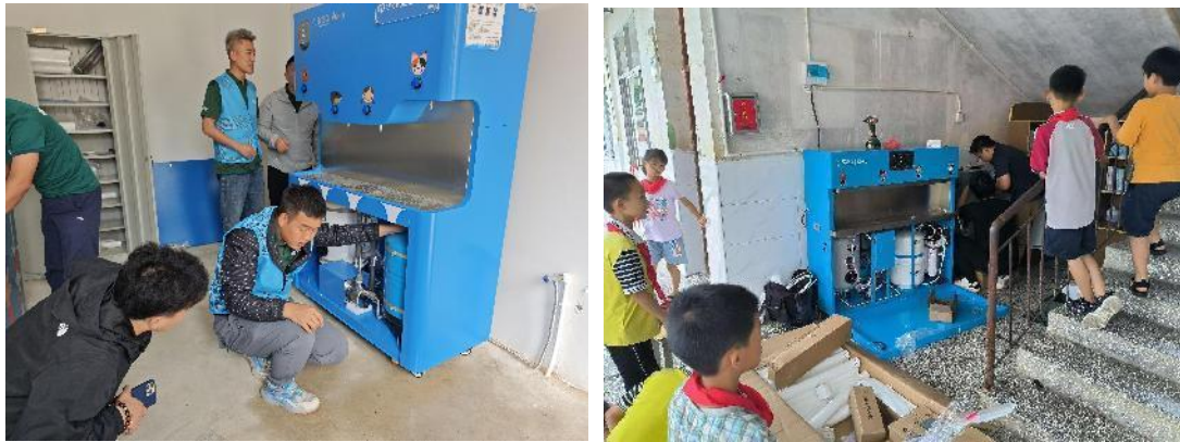
甘肃环县和江西大余县执行伙伴协助安装完成净水设备
