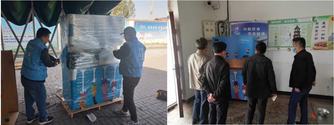
10月底，安徽宿州市萧县项目学校设备安装及教体局领导走访查看
