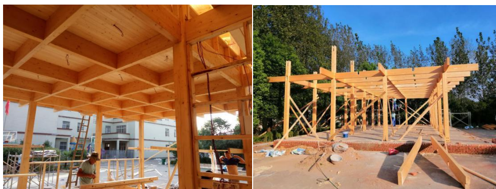
河南光山宴河乡小学主体结构建设完成山西壶关百尺明德小学竣工验收，家具已安装
