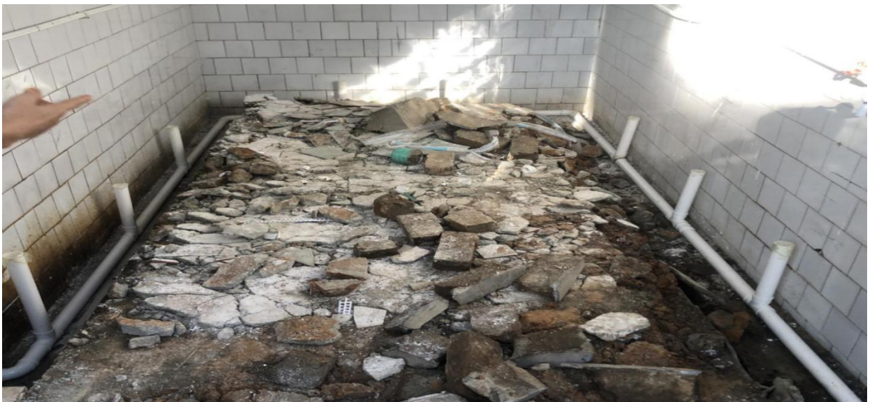
小便器安装场地
